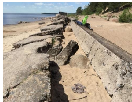
Рисунок 49. Остатки разрушенной бетонной волноотбойной стенки на пляжевой ступени (разрез 17-КПР-I)
