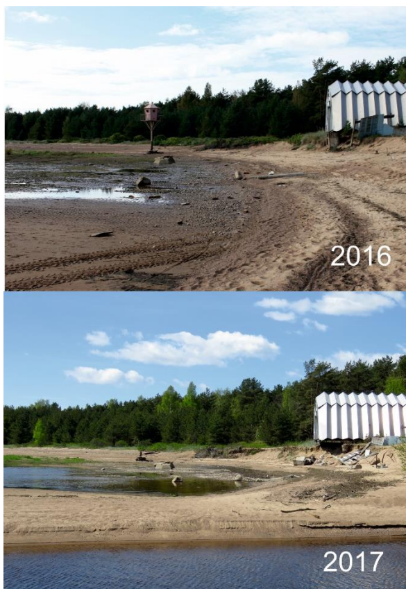
Рисунок 33. Размыв берегового уступа и разрушения основания ангара, как результат развития ЭГП к западу от устья р. Приветная
