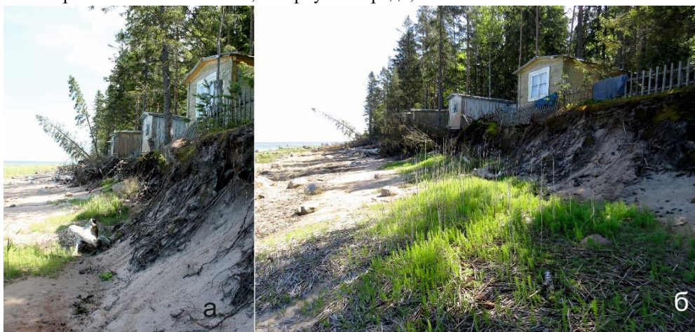
Рисунок 58. Разрушение побережья территории турбазы КМОЛЗ «Янтарный берег» с 2016 по 2017 гг. а – фото 14 июля 2016 г., б – фото 6 июля 2017 г.
