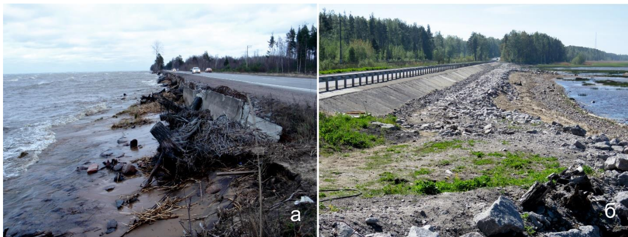
Рисунок 61. Участок шоссе Санкт-Петербург – Ручьи: а – во время шторма 2013 г., с первым вариантом берегозащитных сооружений (фото 17 ноября 2013 г.); б – берегозащитные сооружения, возведенные в 2015 г. (фото 6 июля 2017 г.)
