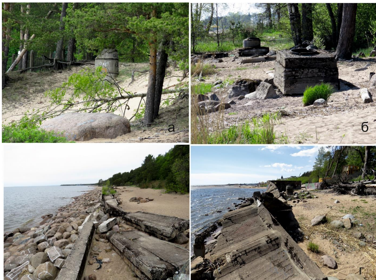
Рисунок 38. Техногенные сооружения в береговой зоне Курортного района (фотографии 2017 г.): а – колодцы коллекторов с размывом основанием в пос. Репино и б – г. Зеленогорск; в – разрушенные волноотбойные стенки в пос. Репино и г – г. Зеленогорск
