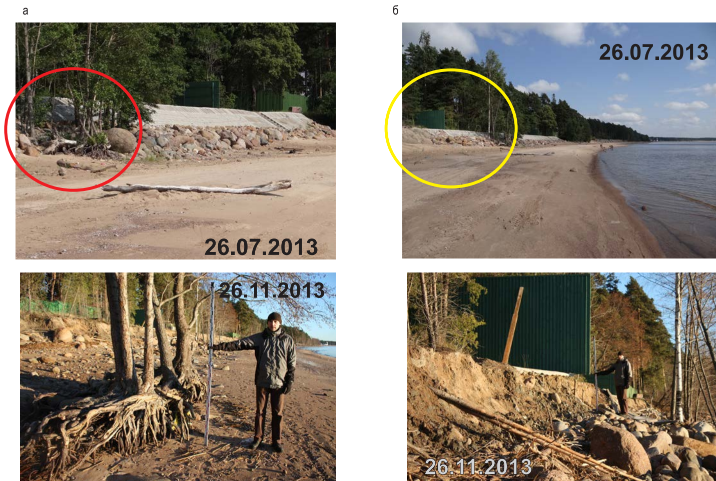
Рис. 46. Результаты непродуманного берегоукрепления в пос. Солнечное с июля по ноябрь 2013 г.: а – размыв берега и разрушение укрепления откосного типа; б – формирование абразионного уступа при разрушении берегозащитного сооружения.
