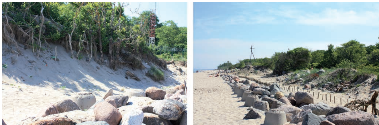
Рис. 130. Размыв авандюны и разрушение берегозащитного сооружения (к востоку от т.н. 13-КК-4).
