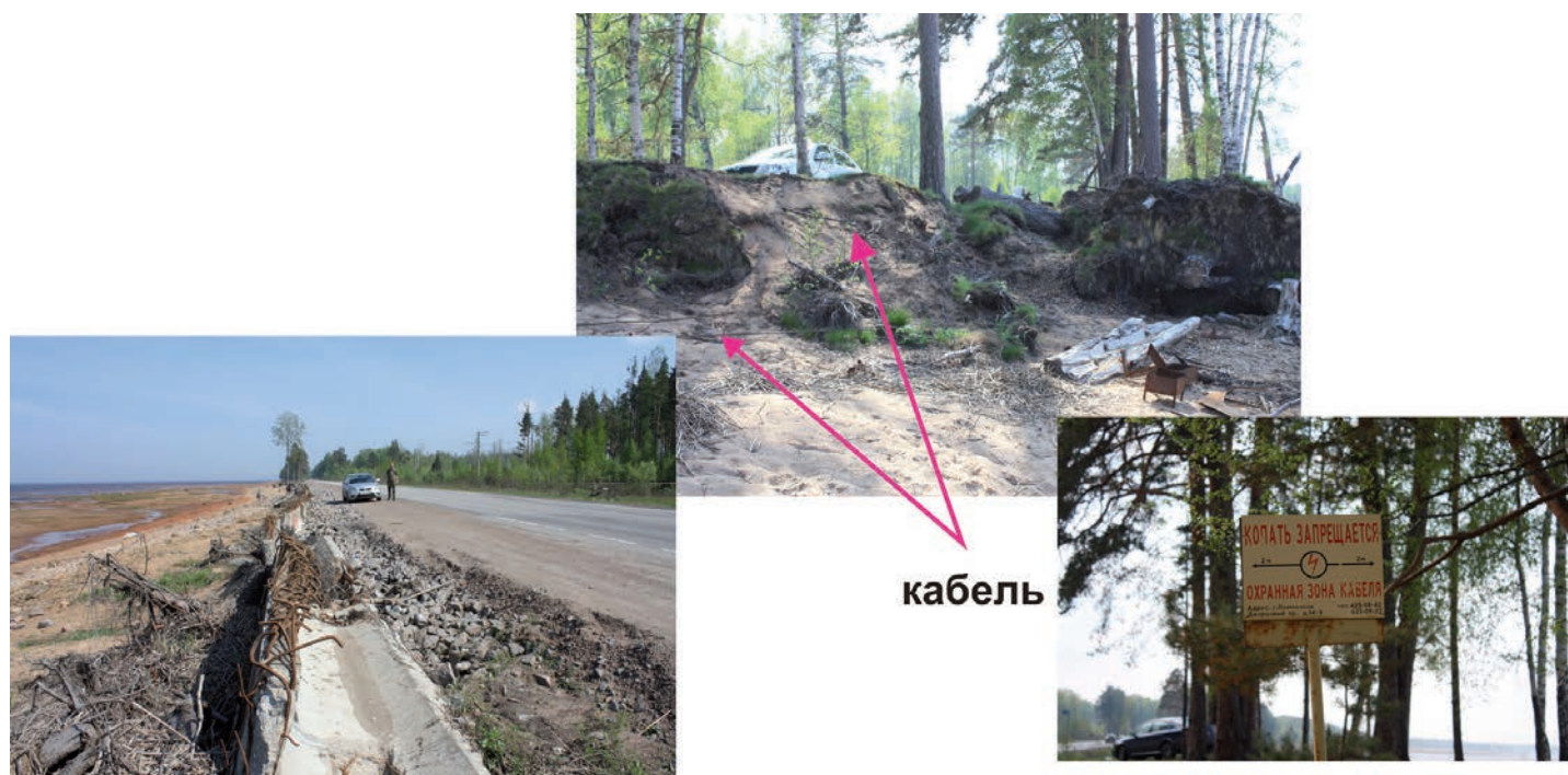
Рис. 60. Аварийный участок береговой зоны в районе размыва шоссе Санкт-Петербург–Ручьи.
